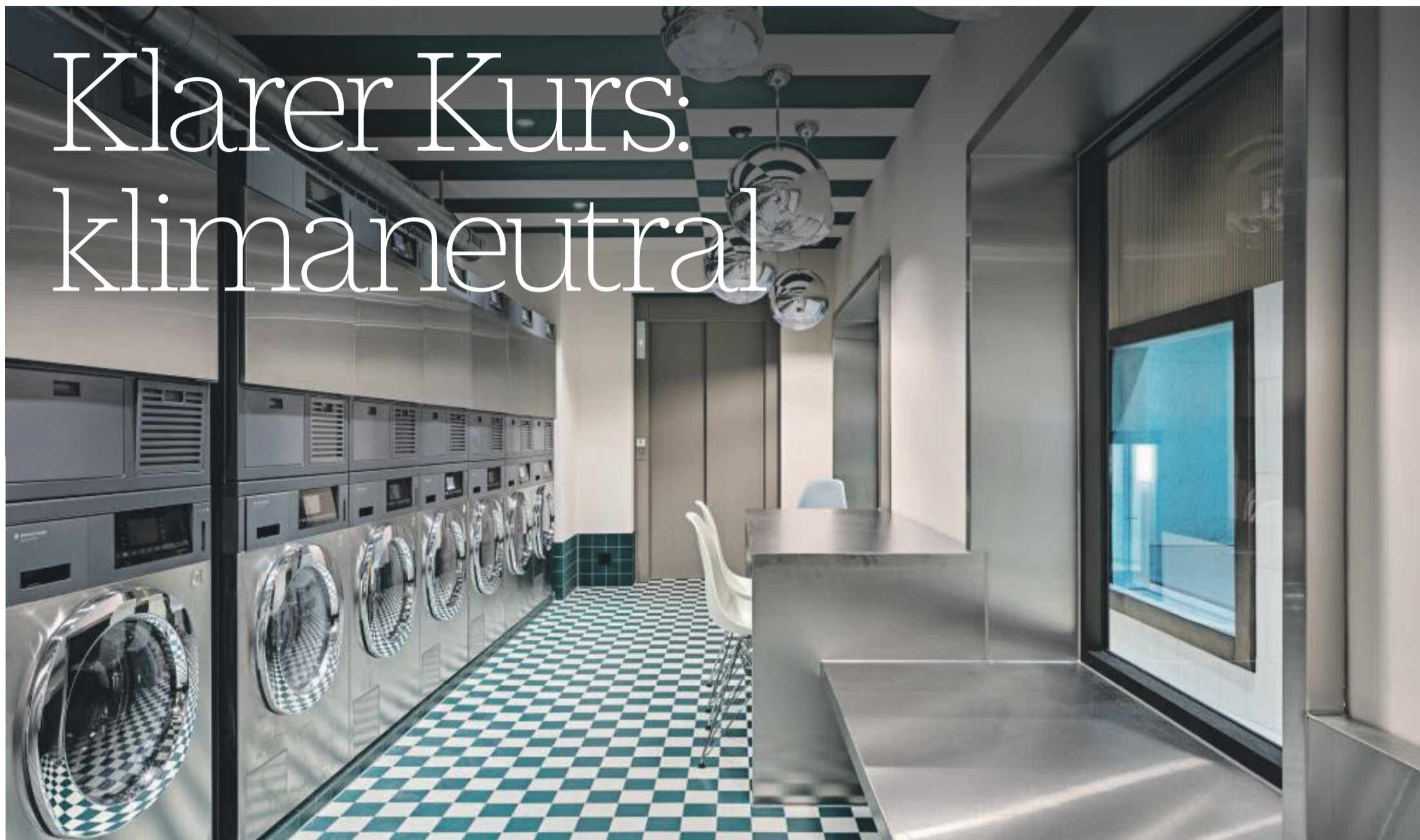
Waschen im grossen Stil: Schulthess hat bei seinen Maschinen die Verbräuche von Strom und Wasser deutlich gesenkt.
